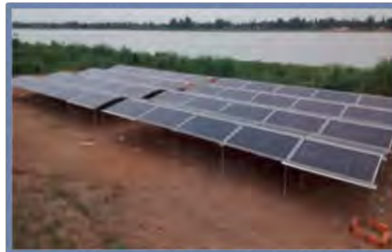
Tan Chau, Vietnam, 22kWp (2018)
