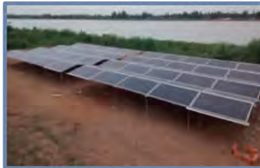
Tan Chau, Vietnam, 22kWp (2018)
